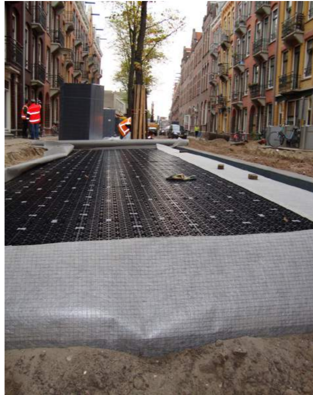
Constructie onder verharding tbv bomen in parkeervoorziening, Balistraat (foto: Jan Wilem Obbink)
