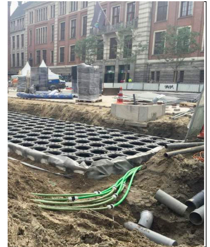
Ondergrondse constructie voor bomen bij hoge verkeersbelasting, Beursplein (foto: Jan Willem Obbink)
